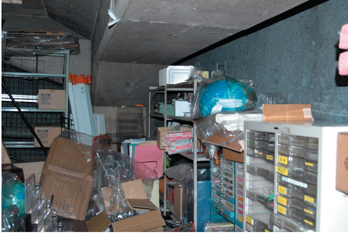
文具店倉庫：右側壁にびっしり青石綿吹き付け部分剥離した跡がめだつ
