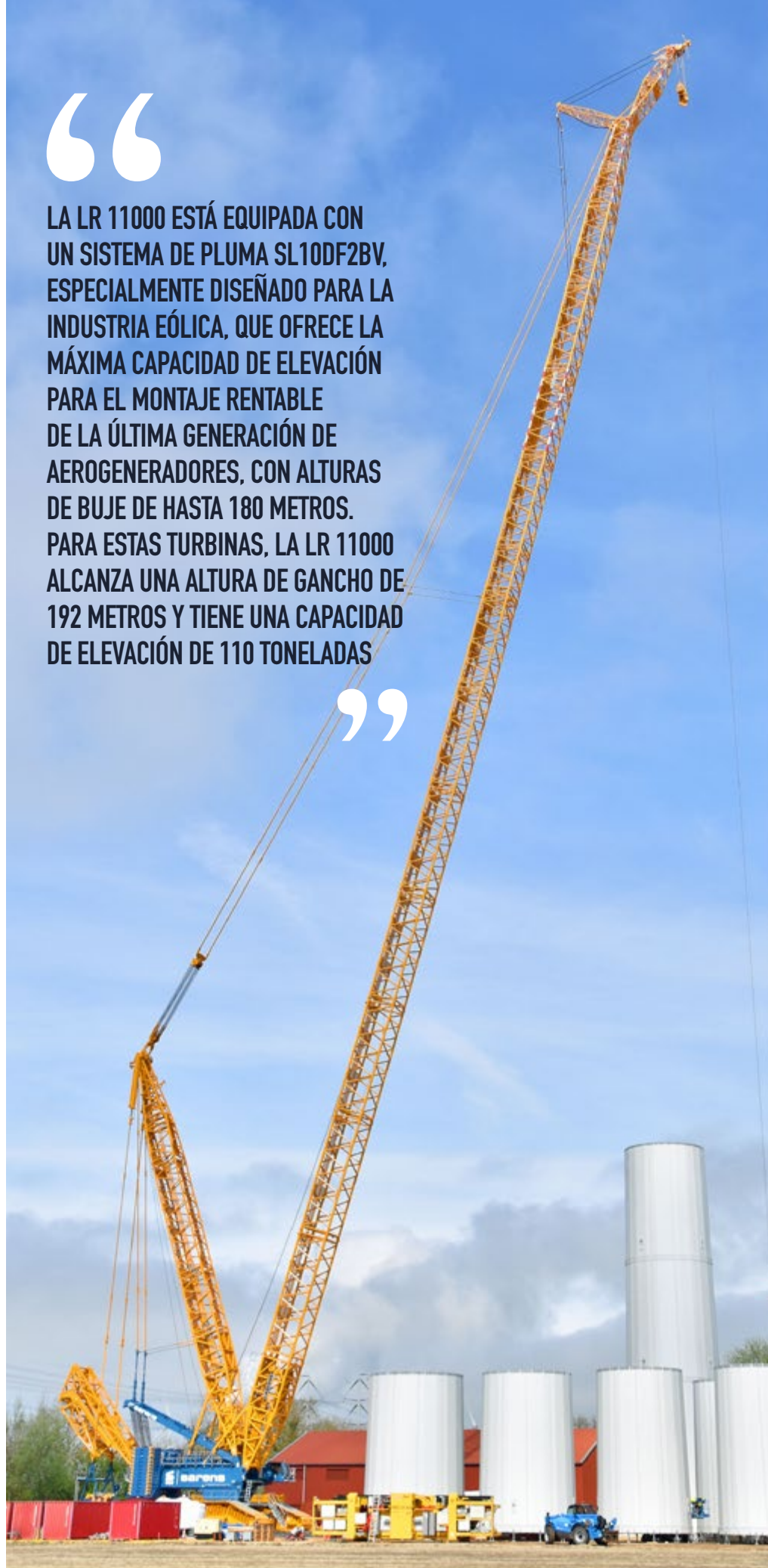
Montaje de turbina eólica: la LR 11000 fue montada con una pluma principal de 162 metros y plumín fijo de 12 metros.
