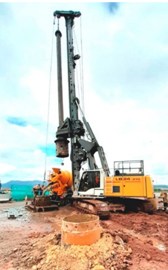
La Liebherr LB24-270 trabaja en las obras de ampliación y enlace de las autopistas A-67 con la A-8, en Santander
