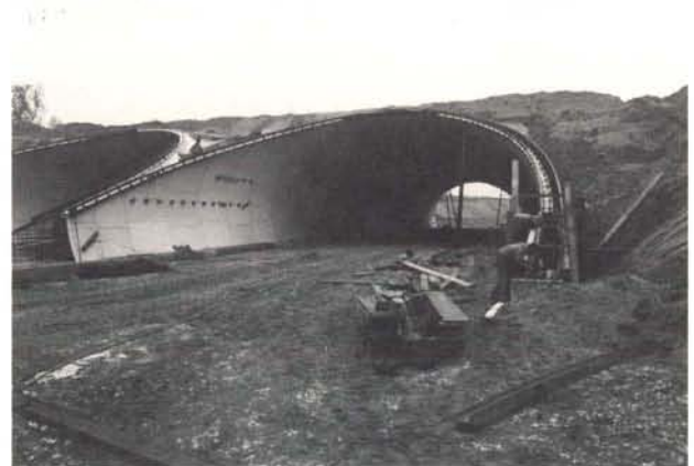
Het cerviduct in rijksweg 50 in aanbouw. Het grofwild kan door de tunnels het verkeer ongestoord kruisen.
