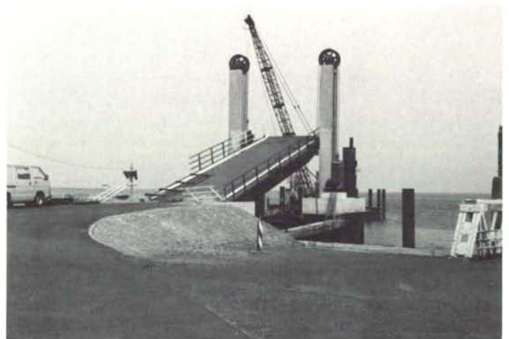
Ro-ro aanleginrichting veerdienst Holwerd - Ameland.
