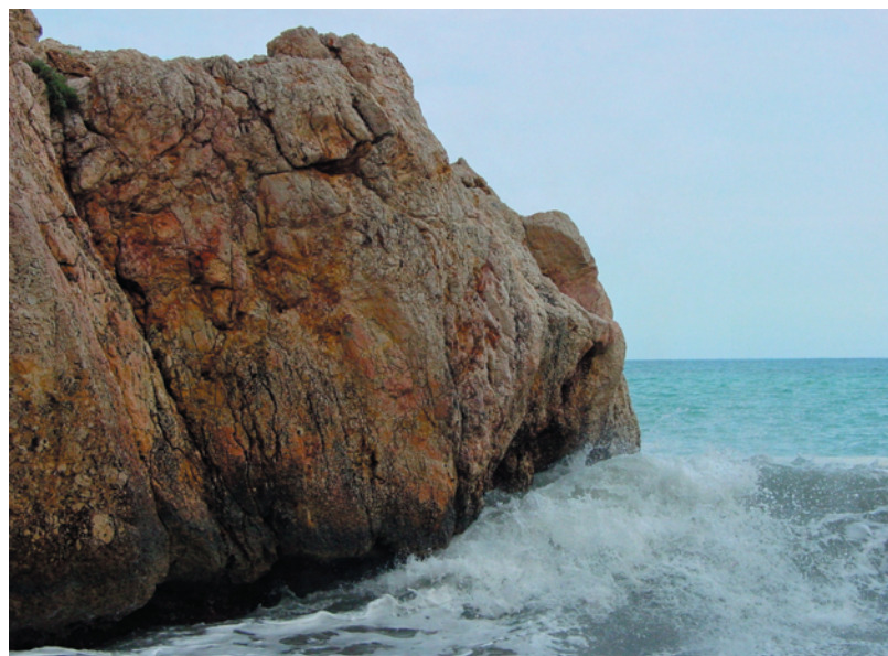
Figura 9. Desarrollo de la socavadura basal situada en la base de los acantilados.
