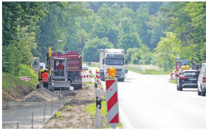
Seit März zieht sich die große Kabelbaustelle der Thüga Energienetze durch Singen hin. Im Bereich der B 34 nördlich des Aluminiumwerks ist dadurch der Radweg für Wochen weggefallen. swb-Bild: of
