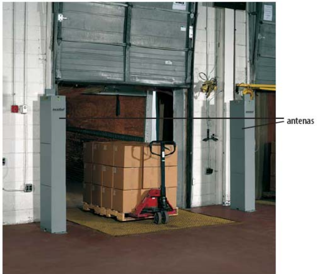
Figura 7.1.2: Portal para lectura de pallets
