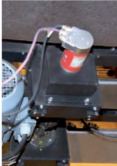
5.2.1.4 Detalle encorder conectado a eje reductor
