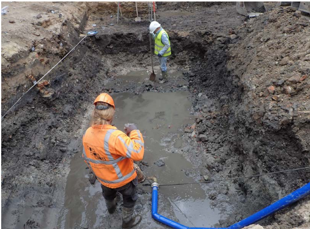
Figuur 15. Gorinchem, Knipsteeg 13-15: Foto van het noordoostelijk deel van put 1. Uit lichtgrijze mortellaag (links van de oranje man) kwam zoveel water vrij dat de pomp er aan te pas moest komen.
