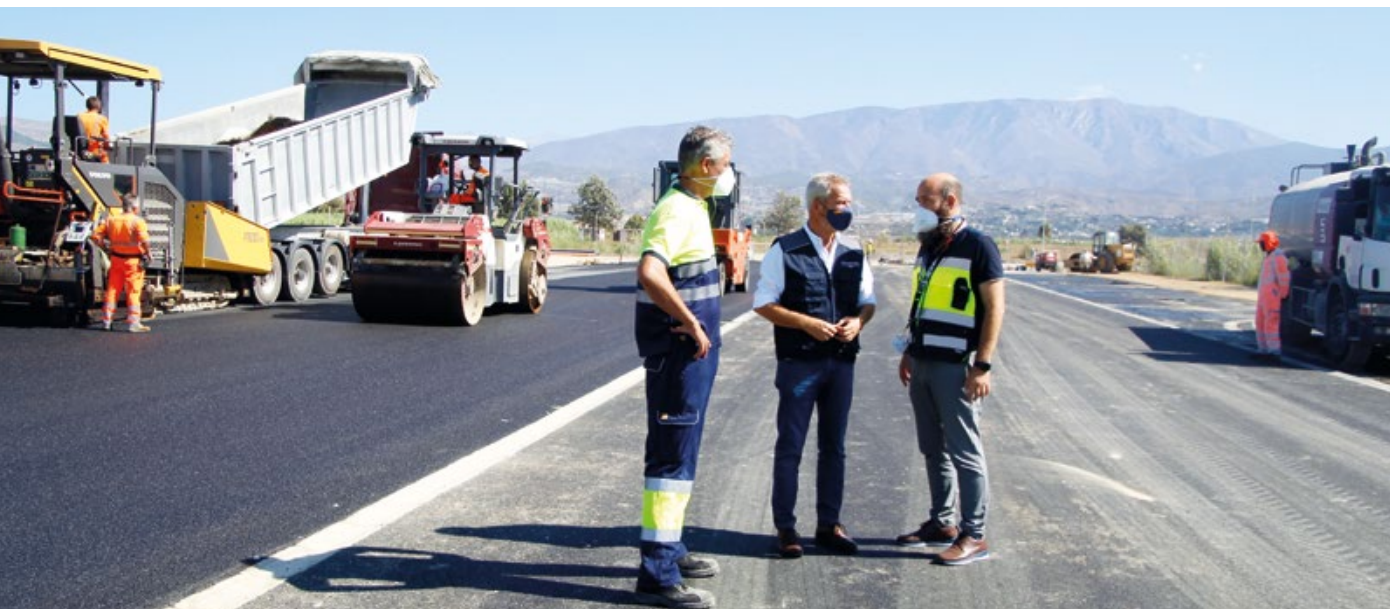
Durante 2021, la Autoridad Portuaria de Motril puso en marcha un acceso terrestre al puerto pensado específicamente para las cargas de grandes dimensiones. En la imagen, el presidente del Puerto de Motril, José García Fuentes, durante una visita a las obras el mes de septiembre.
