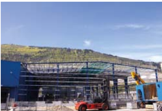
Progeco nueva nave 1.jpg: La nueva nave de 5.000 metros cuadrados de Progeco en el Puerto de Bilbao quedó operativa en el mes de mayo.
