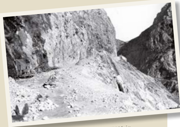
En parts del traçat entre Queralbs i Núria l'explanació va ser tallada a la roca. Arxiu FGC (1929).
