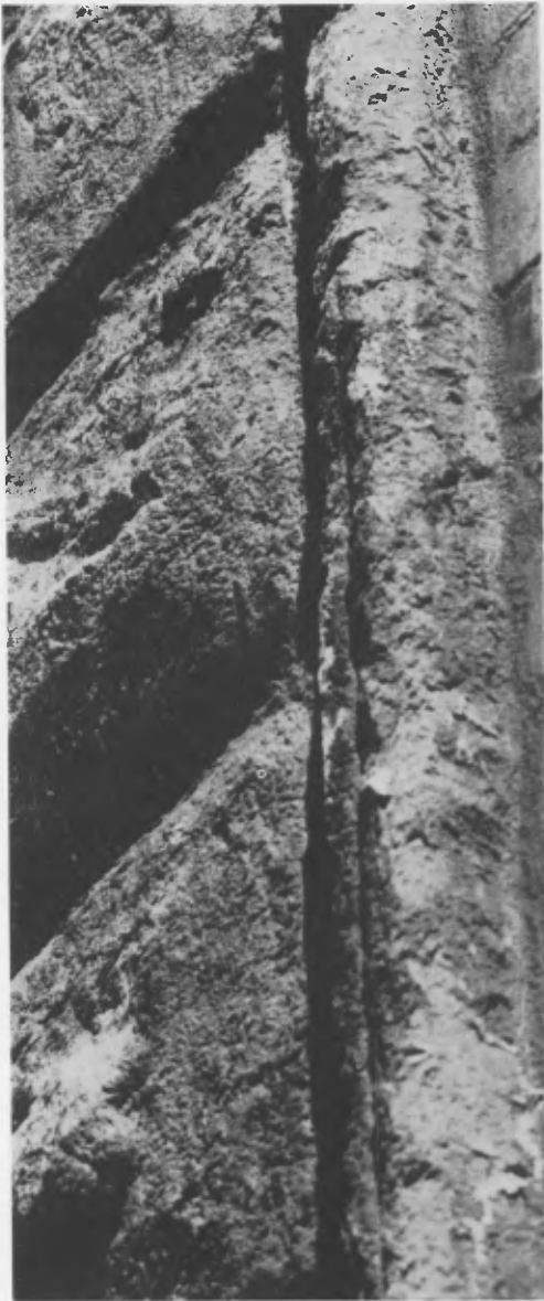
Fig.5 - Palazzo del Podestà, detail after Rhodorsil treatment (1974).
