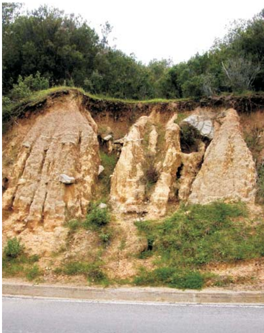
Fig. 46 - Forme erosive pseudocalanche, dovute al ruscellamento concentrato sui depositi colluviali tagliati dalla strada che da Lacona conduce a Marina di Campo.
