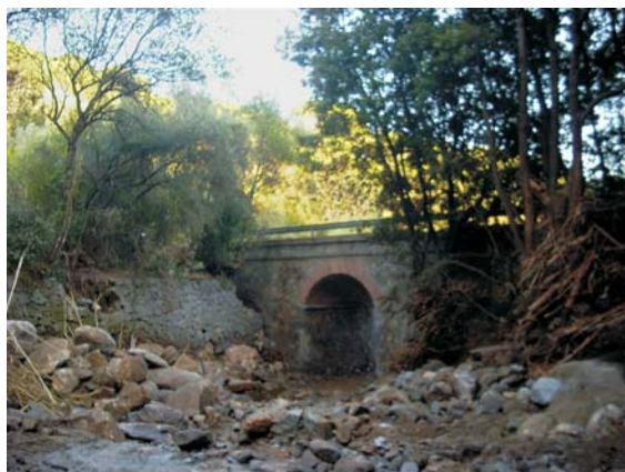
Fig. 125 - Ponte sul fosso Stabbiati, lungo la strada Marina di Campo - Cavoli, alcuni giorni dopo l'evento alluvionale del 7 novembre 2011. L'ostruzione della luce del ponte, da parte del carico solido trasportato dall'onda di piena, ha causato l'esonazione a monte e il sormonto dell'opera stessa.
