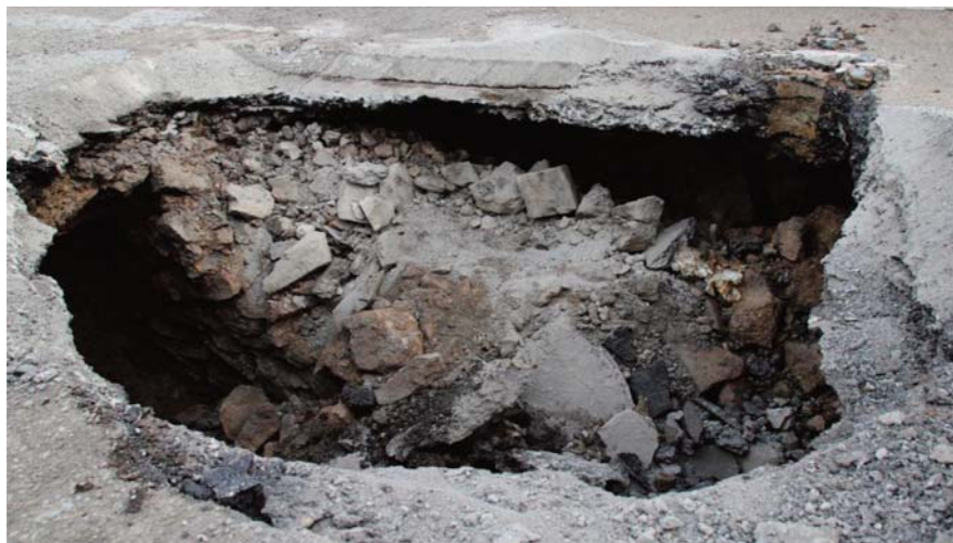
Fig. 131 - Sinkhole del 4 febbraio 2014, che ha interessato la sede stradale della S.P. 26.
