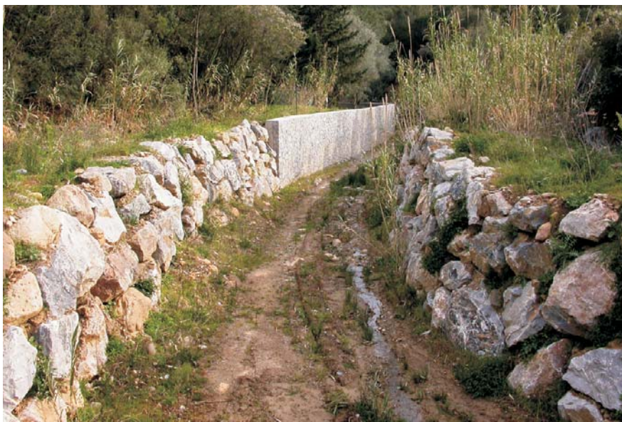
Fig. 117 - Opere di sistemazione idraulica lungo il fosso della Madonna (territorio comunale di Portoferraio), che hanno sensibilmente ridotto la sezione naturale dell'alveo.
