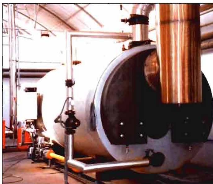
Figura 11. Caldera de calefacción por agua caliente.
