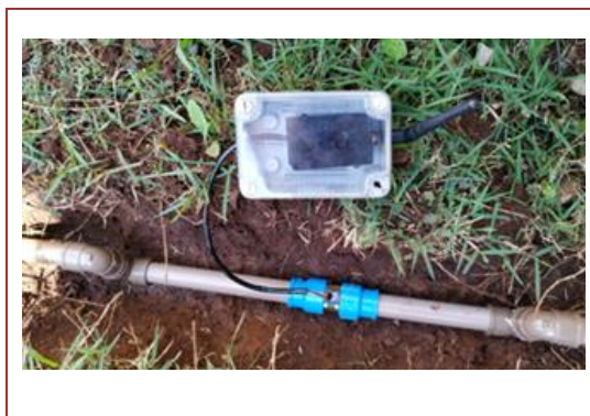
Figura 2. Medidor instalado na entrada da residência.
