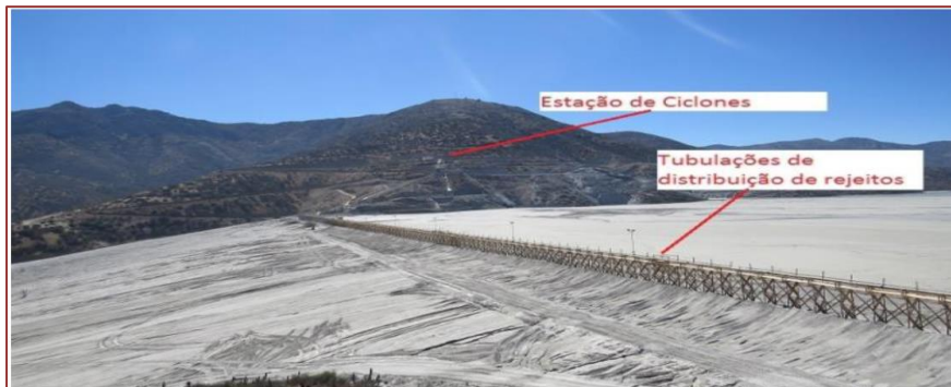
Figura 13 - Arranjo da estação de hidrociclones e tubulações sobre a barragem El Mauro no Chile
