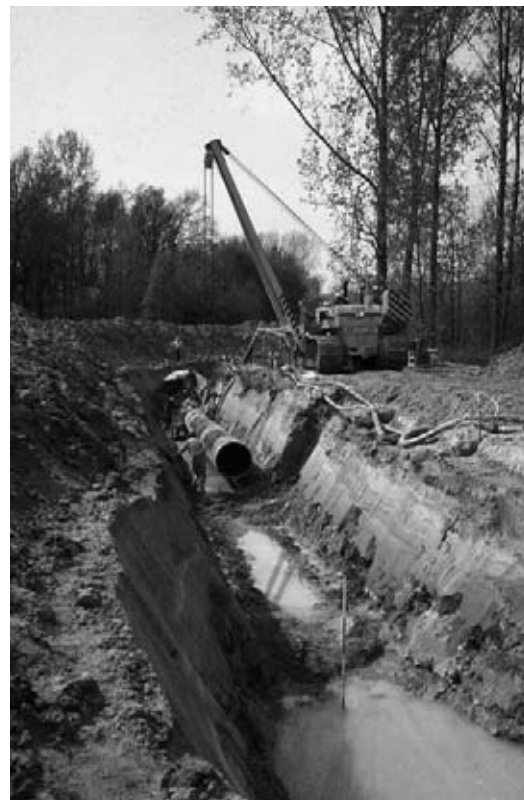
9 Het leggen van de buizen in de C-sleuf te Houtem (Vilvoorde, prov. Vl.-Brabant). The installation of the pipes in deep-trench C in Houtem (Vilvoorde, prov. of Flemish Brabant).
