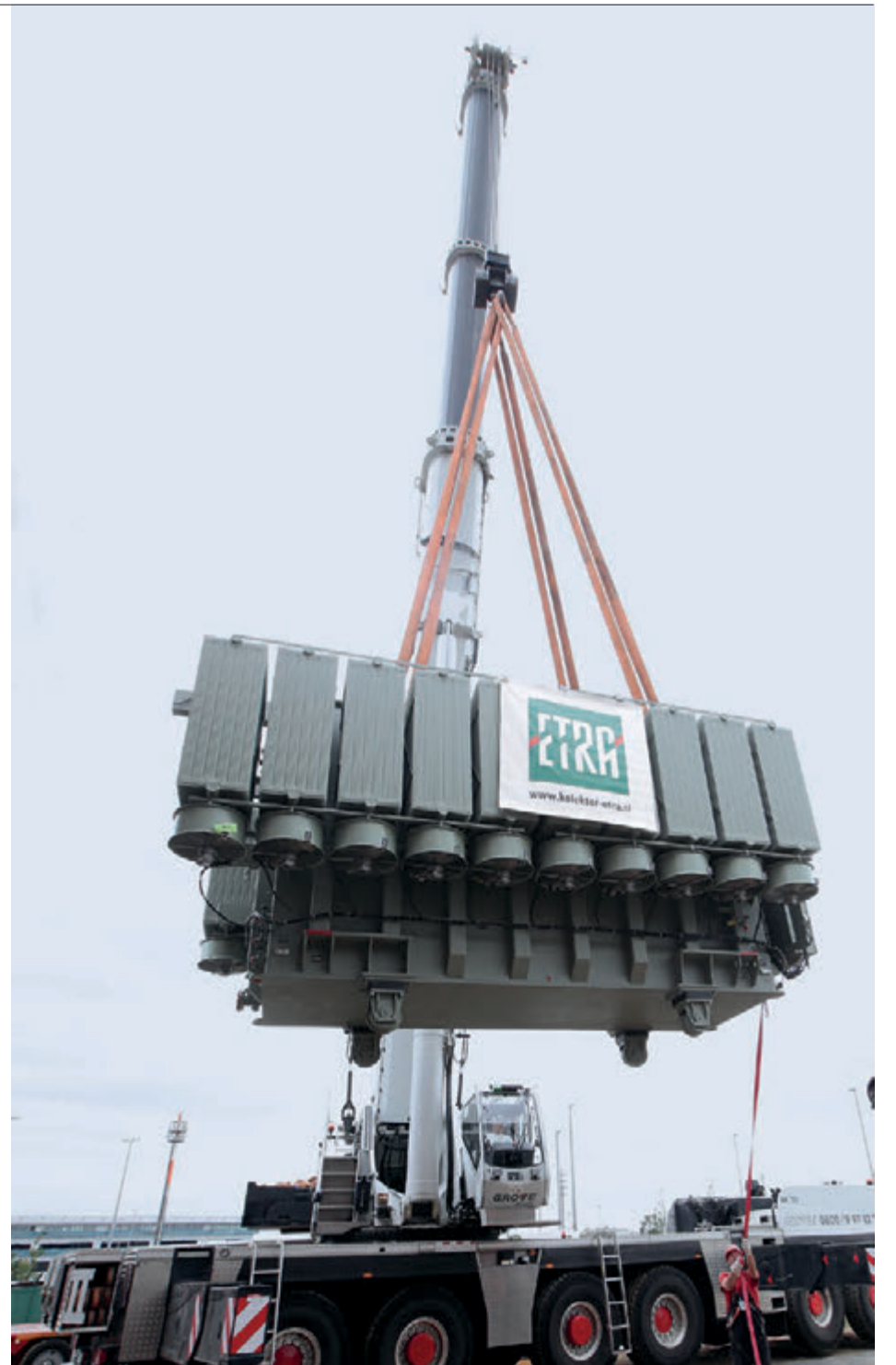
Transformatoranlieferung für ein neues Umspannwerk: Mainova baut die Infrastruktur aus. Bild: Mainova
