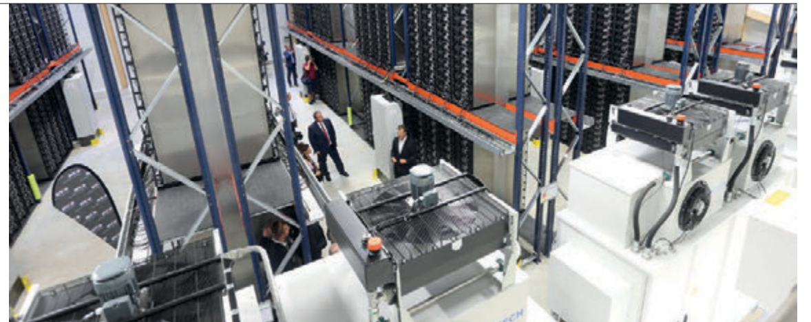
Batteriespeicher bei Eins Energie: Der Energiedienstleister gehört zum Beteiligungsportfolio der Thüga.
