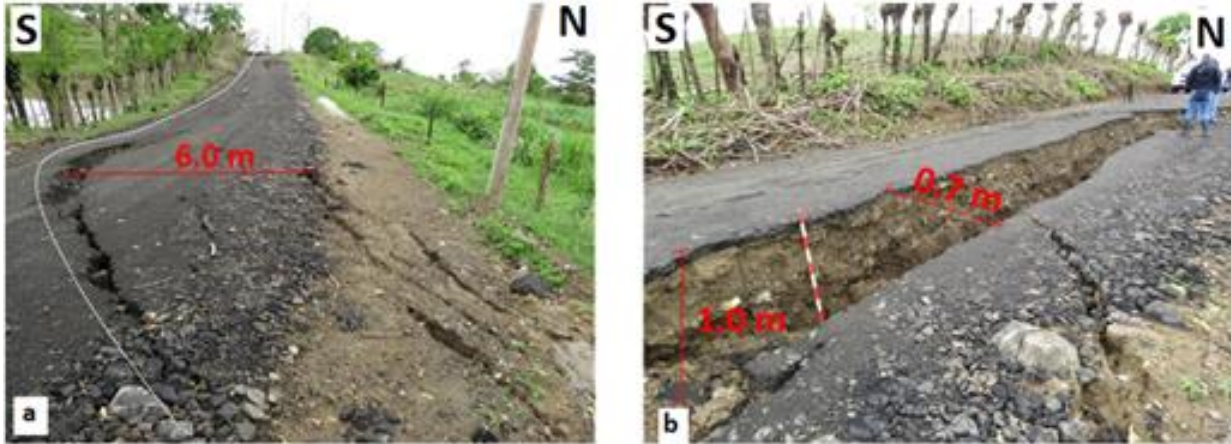
Figura 60. Afectación de la vía al cerro Santa Cruz por deslizamiento
